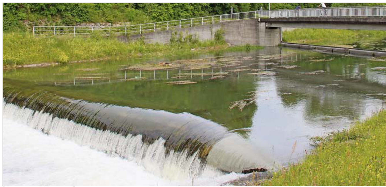
Die fest installierte Ölsperre bei Hochfelden wurde ebenfalls hochgefahren.
